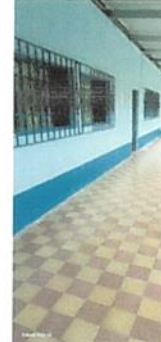
Foto 2: VENTANAS CORREDIZAS EN AULAS
